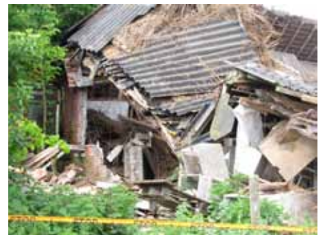
Bij veel boerderijen is asbest toegepast
